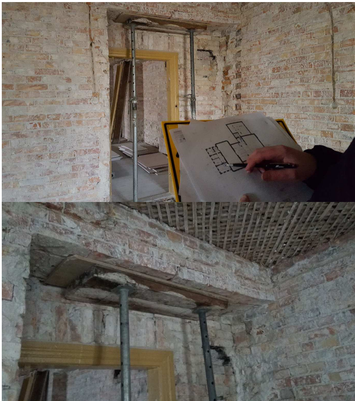
Rys. Zbliżenie na uszkodzone nadproże.
